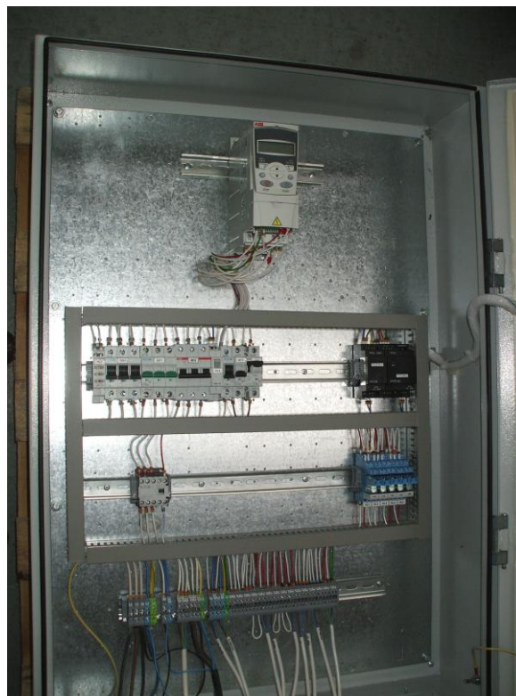
Внутренняя конструкция щита управления СА-1 с преобразователем частоты АВВ АС310
